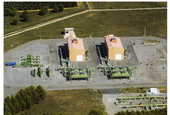
Poste de compression de Barbaira (11)
